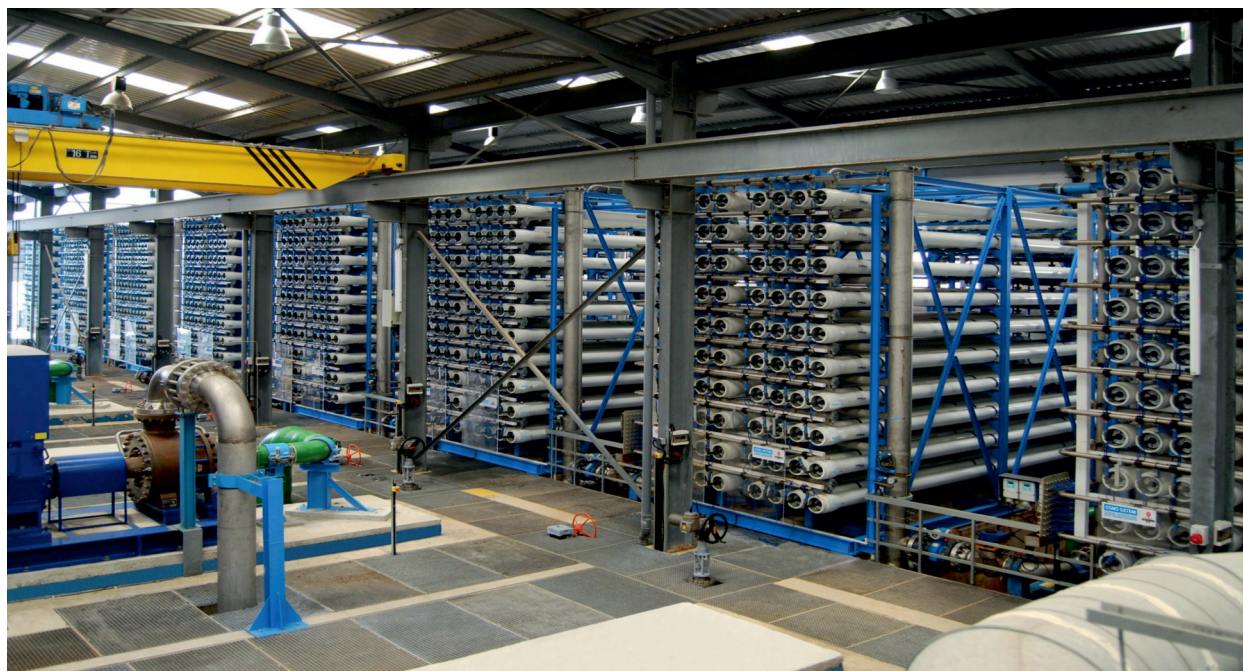
Εργοστάσιο Αφαλάτωσης Δεκέλειας - Κύπρος, SWRO, δυναμικότητας 60.000 m 3 /ημέρα, πόσιμο νερό, σύμβαση BOOT
