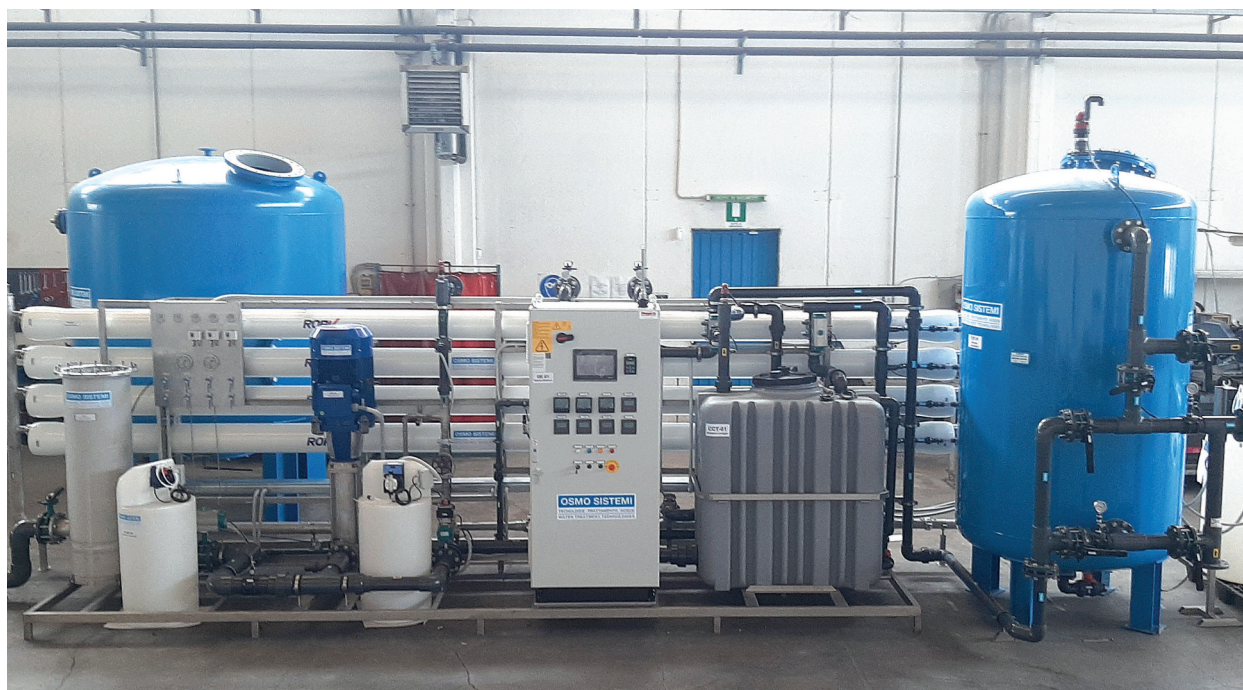
Skid-mounted μονάδα BWRO – 500 m 3 /ημέρα
