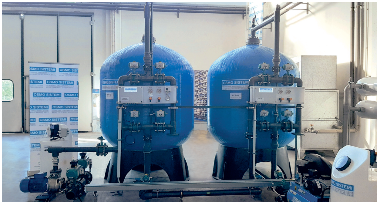
Βιομηχανική εγκατάσταση – εφαρμογή RO
