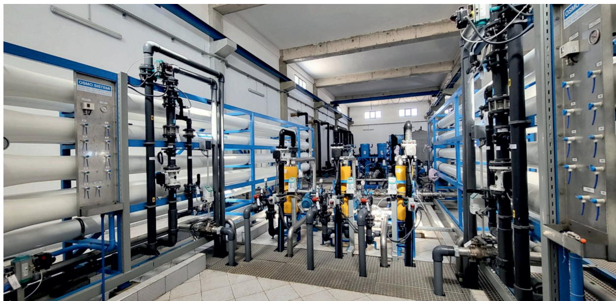
Εργοστάσιο αφαλάτωσης Terfaya – Μαρόκο (SWRO 2 X 650 m 3 /ημέρα, πόσιμο νερό)
